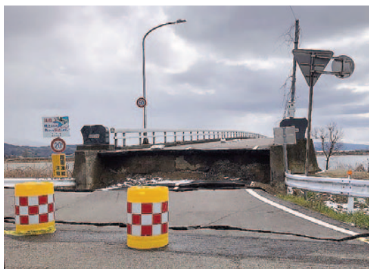
内灘町 橋桁が隆起して通行できない橋
