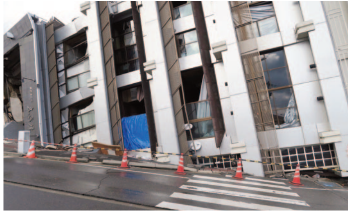
横倒しになったビル
