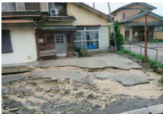
内灘町 液状化した家屋前
