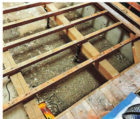
泥水が乾燥した床下
